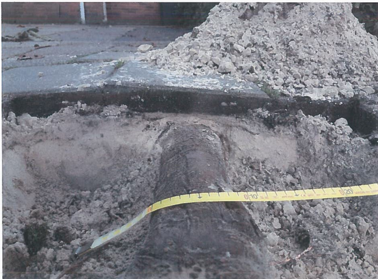
Foto 19: beworteling in proefseuf 4 richting de oprit van huisnummer 79 (t.h.v. boom 092480)
