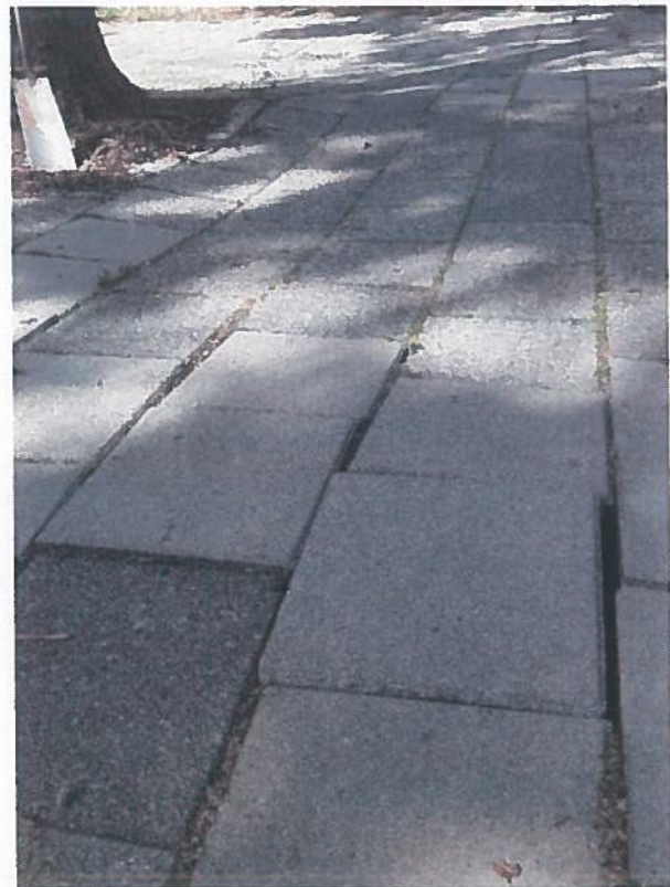
Foto 3: wortelopdruk bij nieuw aangebrachte tegels
